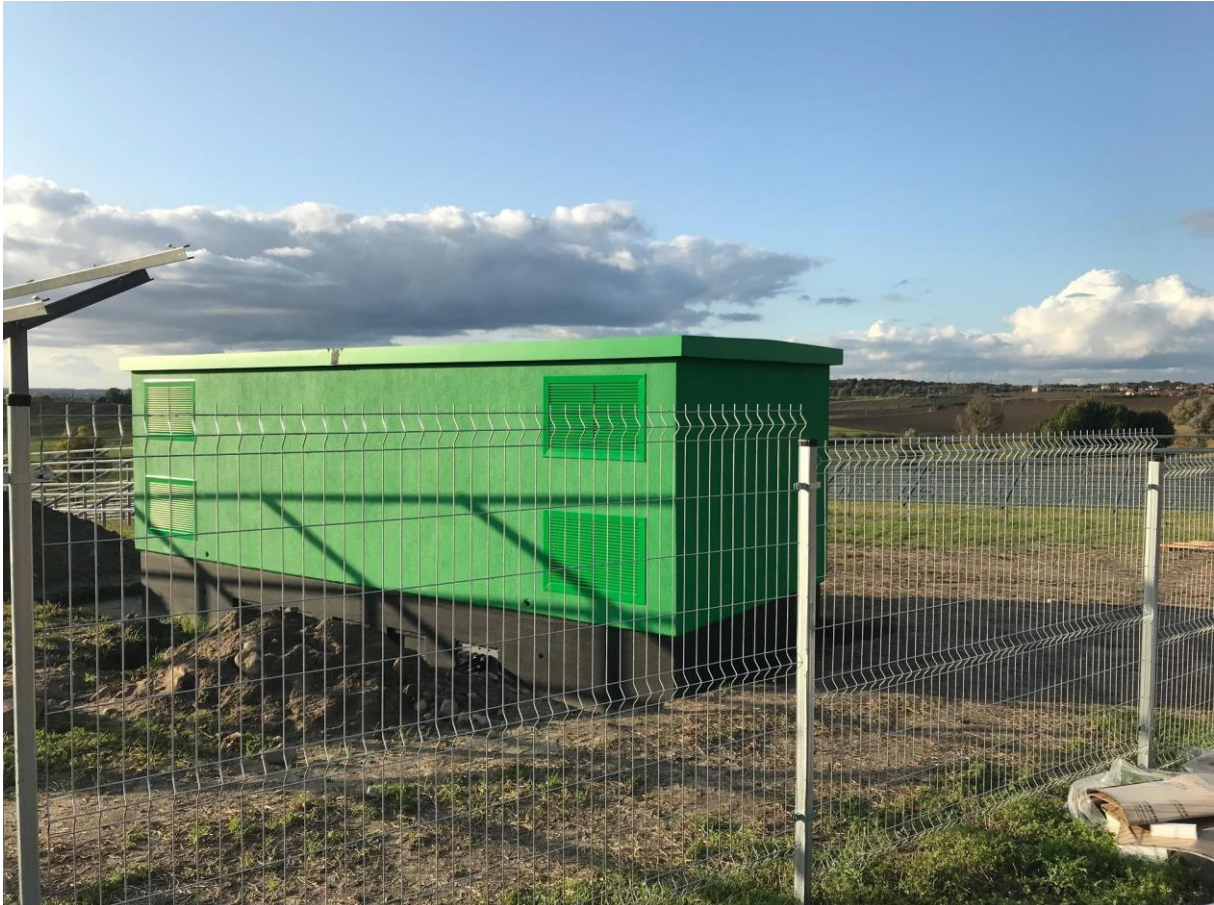
Ryc. nr 10 Przykładowa stacja transformatorowa
