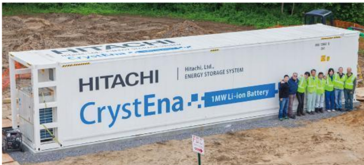
Ryc. nr 11 Przykładowy kontenerowy magazyn energii o pojemności 1 MW, Hitachi „CrystEna”. Inwestor planuje zastosowanie wtapiających się kolorów kontenera.
