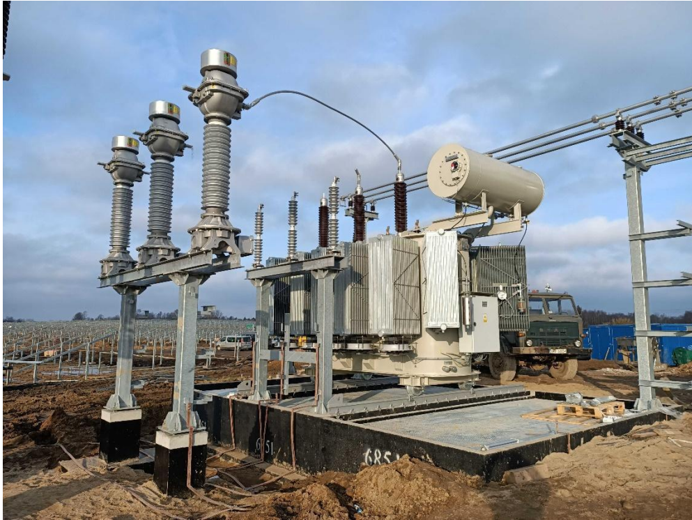
Ryc. nr 13 Przykładowe stanowisko transformatora z misą olejową
