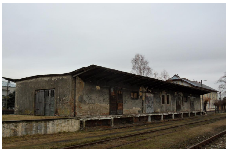
Fot. 22. Opuszczona stacja PKP i magazyny we Wróbliku Szlacheckim – brak nietoperzy
