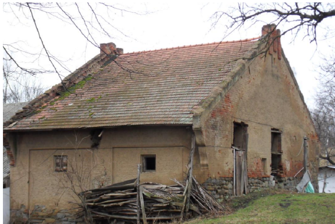
Fot. 24. Opuszczony dom we Wróbliku Szlacheckim – brak nietoperzy (sprawdzono również poddasze – brak guana).
